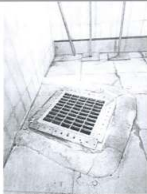
图 3-13 辐照室排风口
